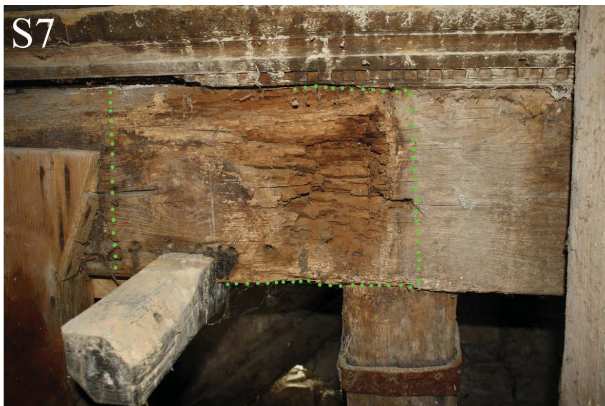
Sonda č.7. lokalizácia poškodených častí hnilobou a drevokazným hmyzom /múčna hrada /
