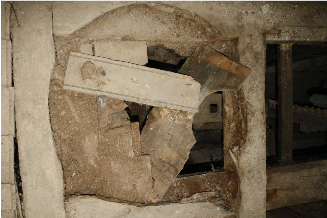
Obr.č.26. poškodenie podesty /medzi podlažia / vrchný pohľad.
