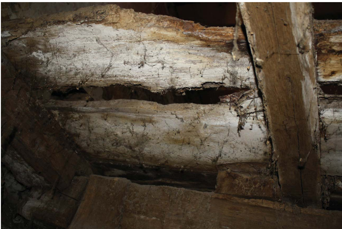
Obr.č.23. poškodenie podesty /medzi podlažia / spodný pohľad.
