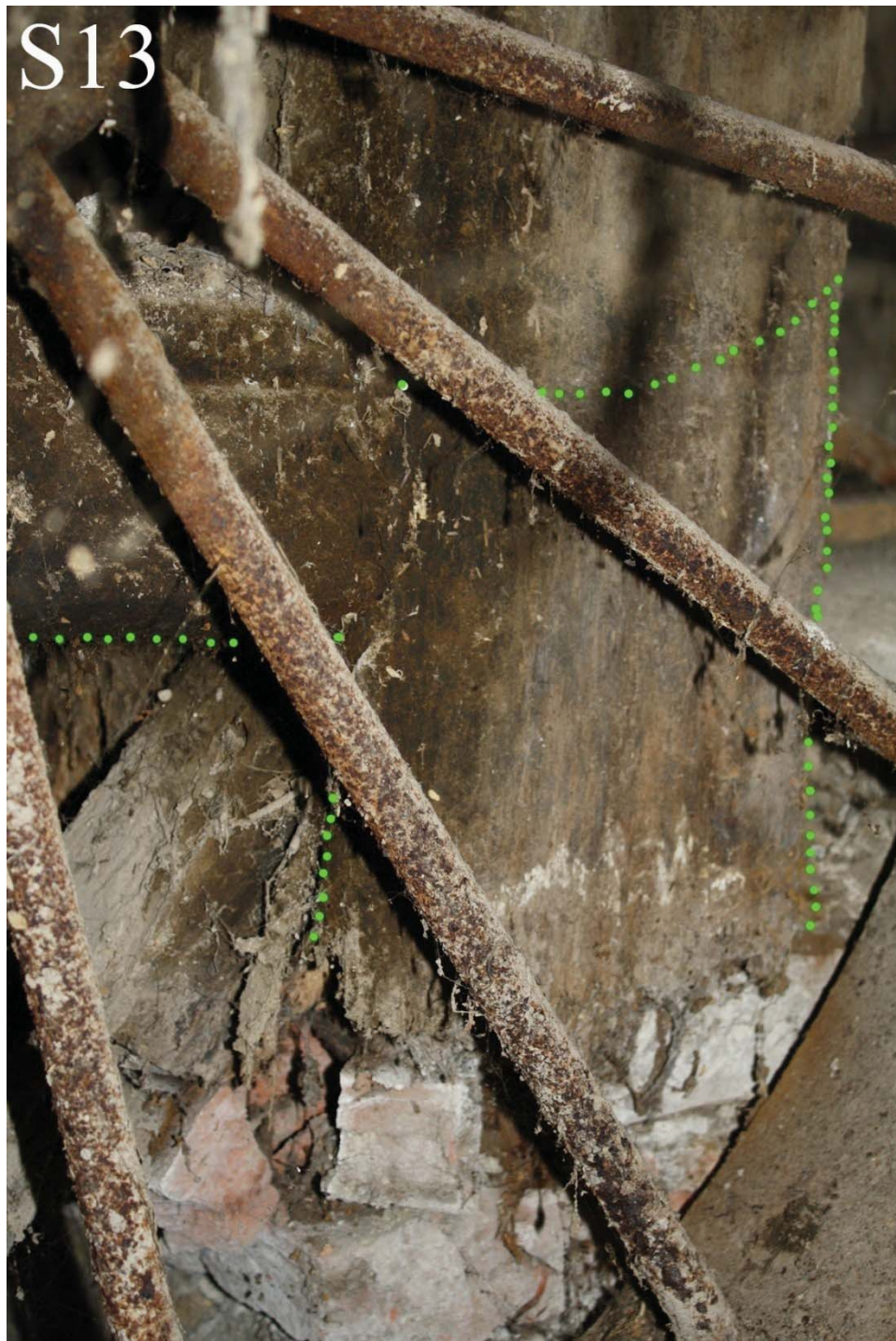
Sonda č.13. lokalizácia poškodených častí hnilobou a drevokazným hmyzom /svorový stĺp- spodná časť dosadajúca na podlahu /
