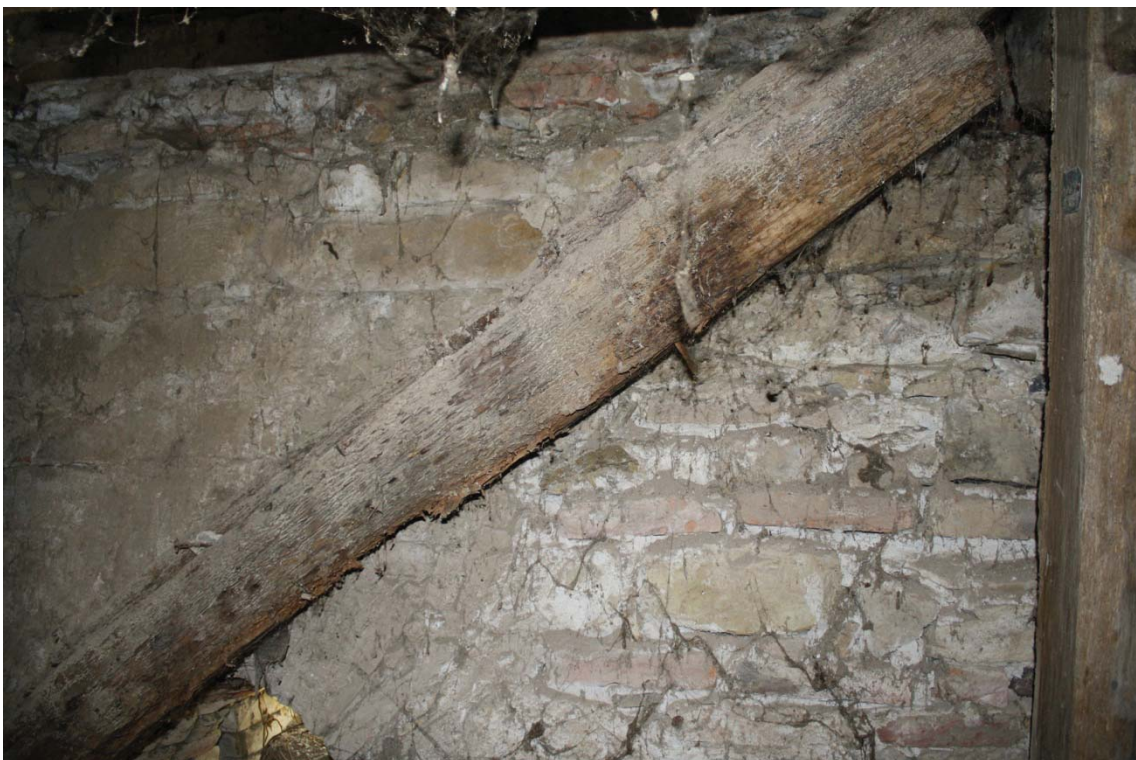
Obr.č.27. spadnutý trám nosnej konštrukcie.
