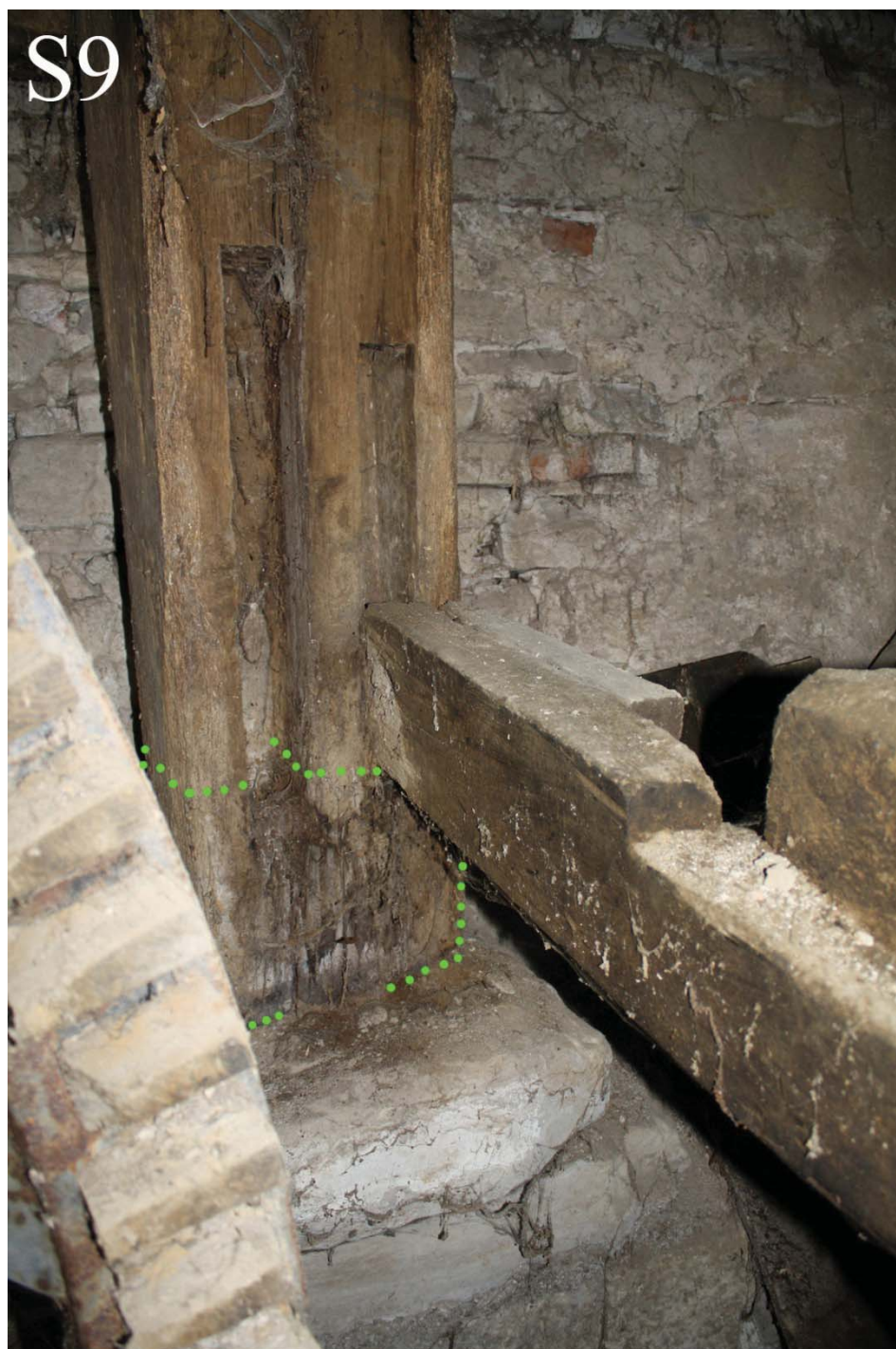
Sonda č.9. lokalizácia poškodených častí hnilobou a drevokazným hmyzom /svorový stĺp- spodná časť dosadajúca na kamennú pätku /
