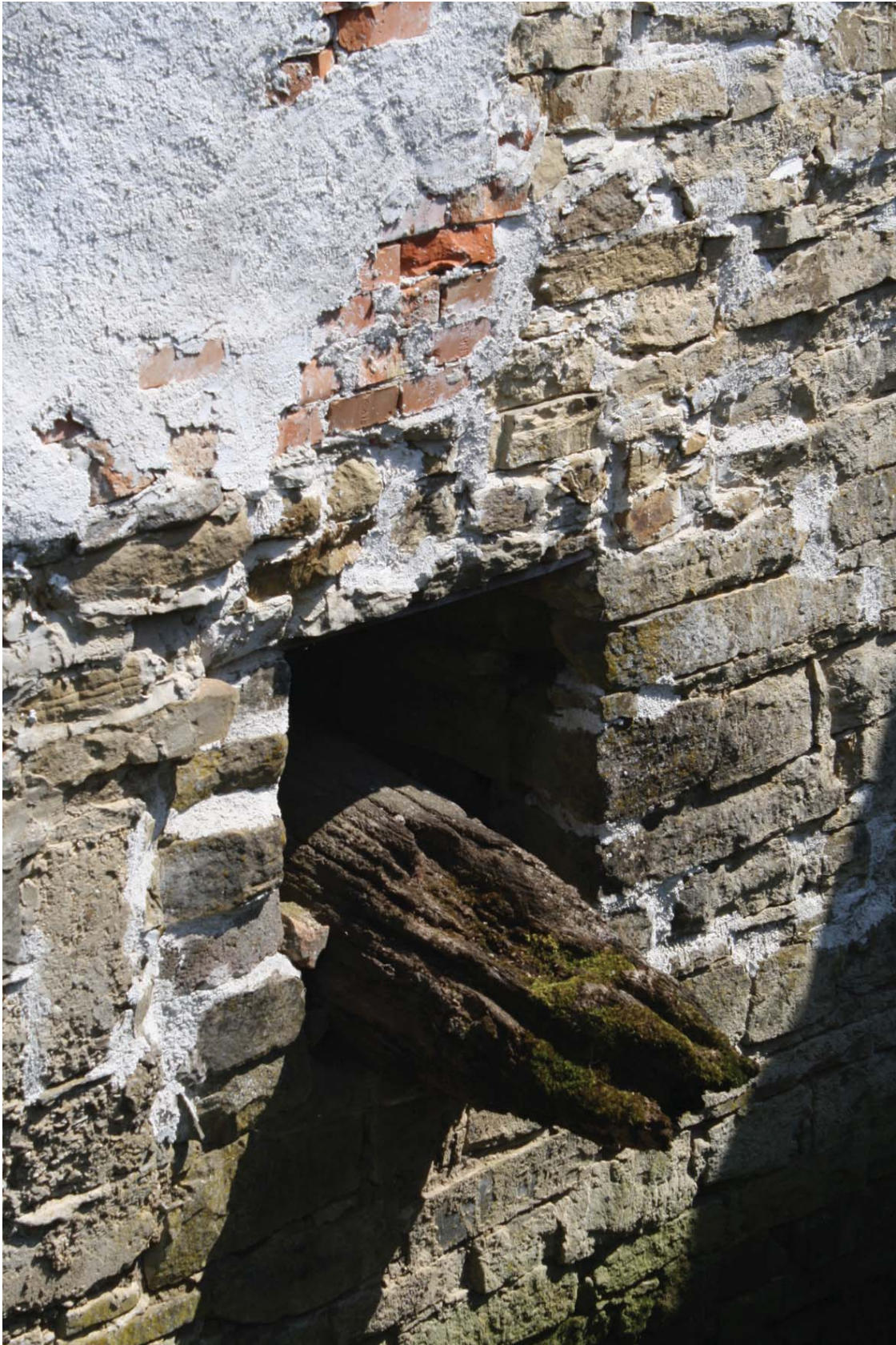
Obr.č.13. dubová hriadeľ, vonkajšia časť poškodená hnilobou - stav pred reštaurovaním.
