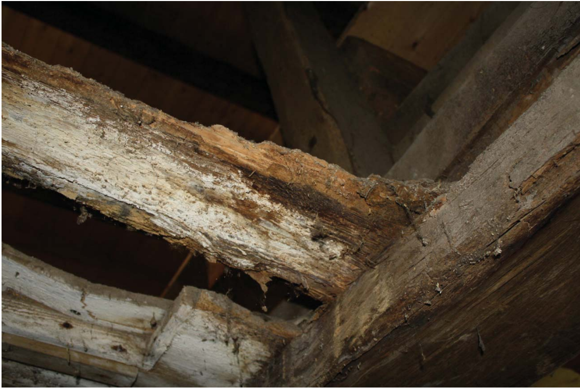
Obr.č.22. poškodenie podesty /medzi podlažia / spodný pohľad.
