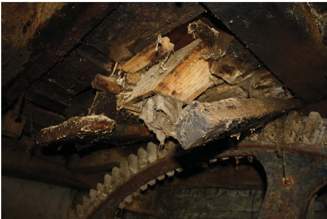
Obr.č.12. poškodenie podesty - spodný pohľad
