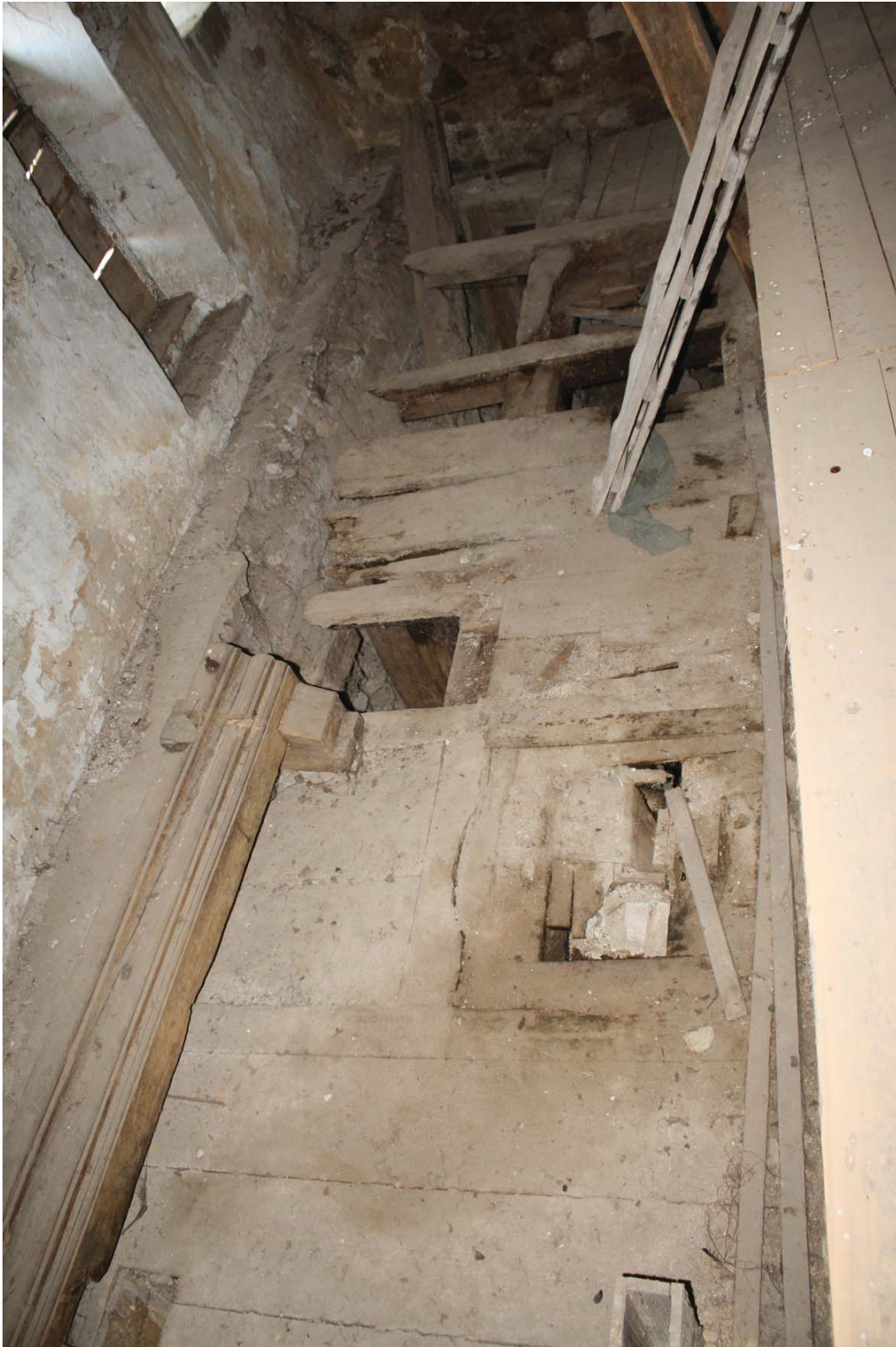
Obr.č.20. poškodenie podesty /medzi podlažia / vrchný pohľad.
