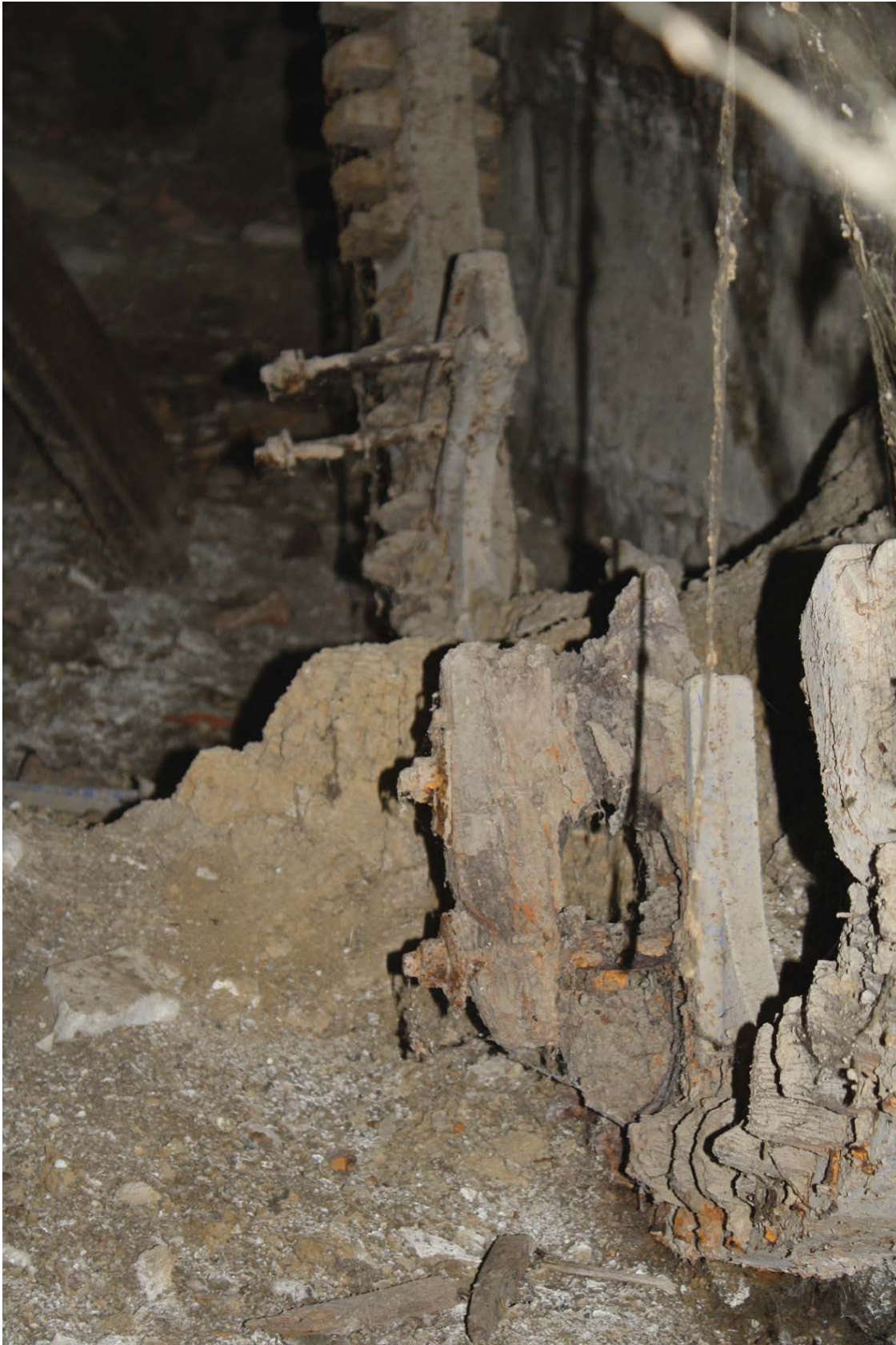
Obr.č.15. poškodenie spodnej časti palečného kolesa.
