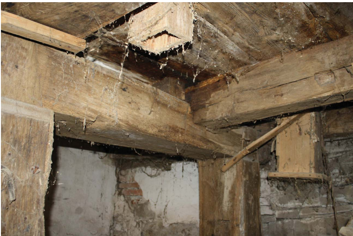
Obr.č.31. drevené konštrukcia mlynskej hranice - stav pred reštaurovaním..
