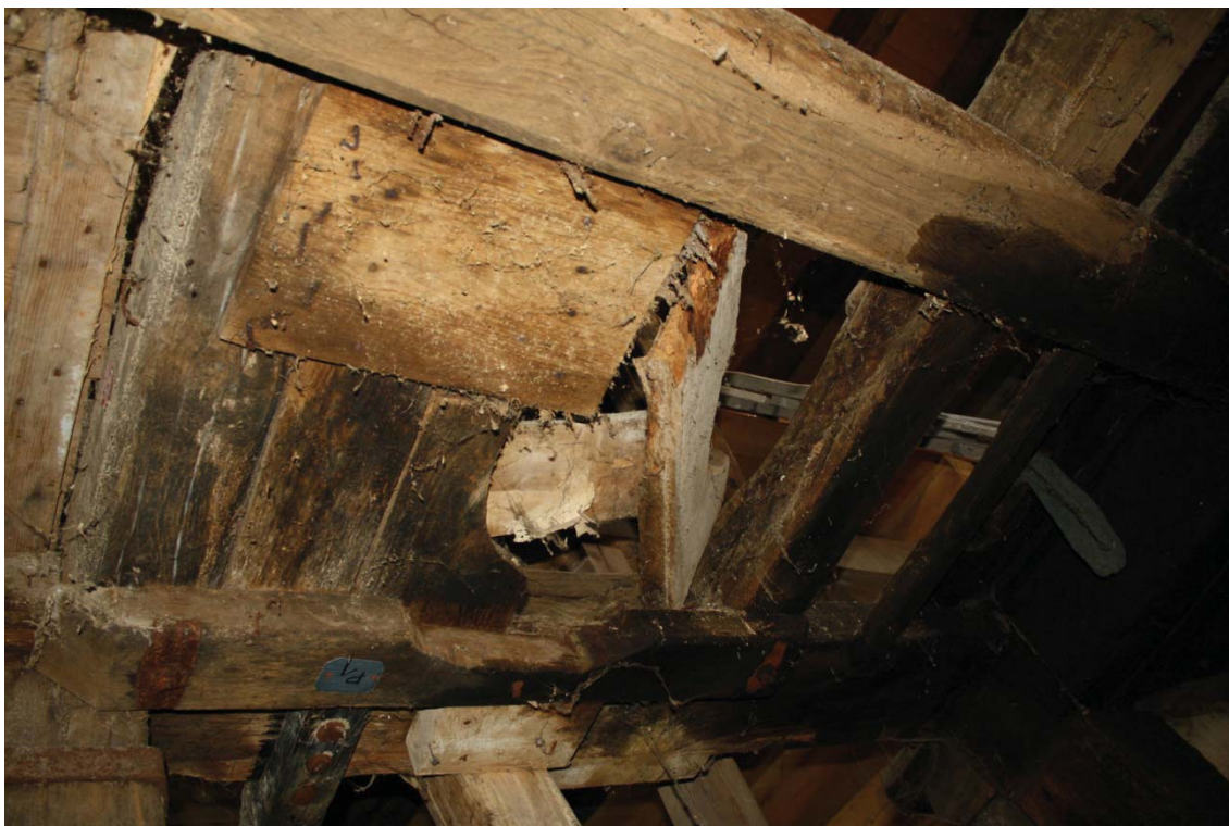
Obr.č.28. poškodenie podesty /medzi podlažia / spodný pohľad.
