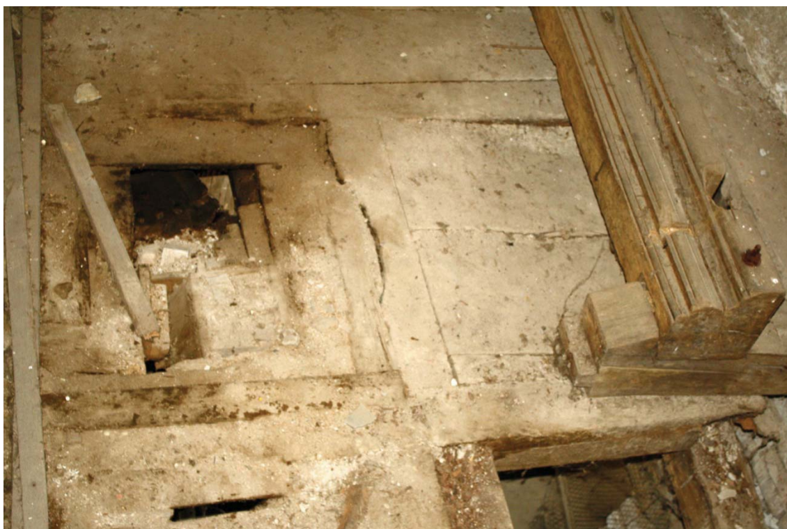
Obr.č.29. poškodenie podesty /medzi podlažia / vrchný pohľad.
