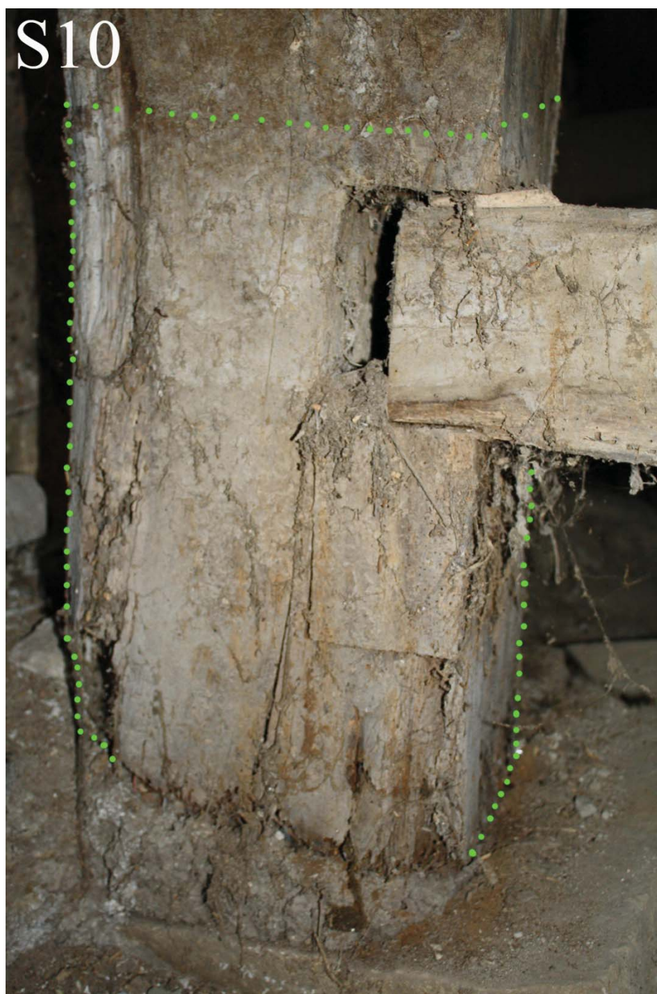
Sonda č.10. lokalizácia poškodených častí hnilobou a drevokazným hmyzom /svorový stĺp- spodná časť dosadajúca na podlahu /
