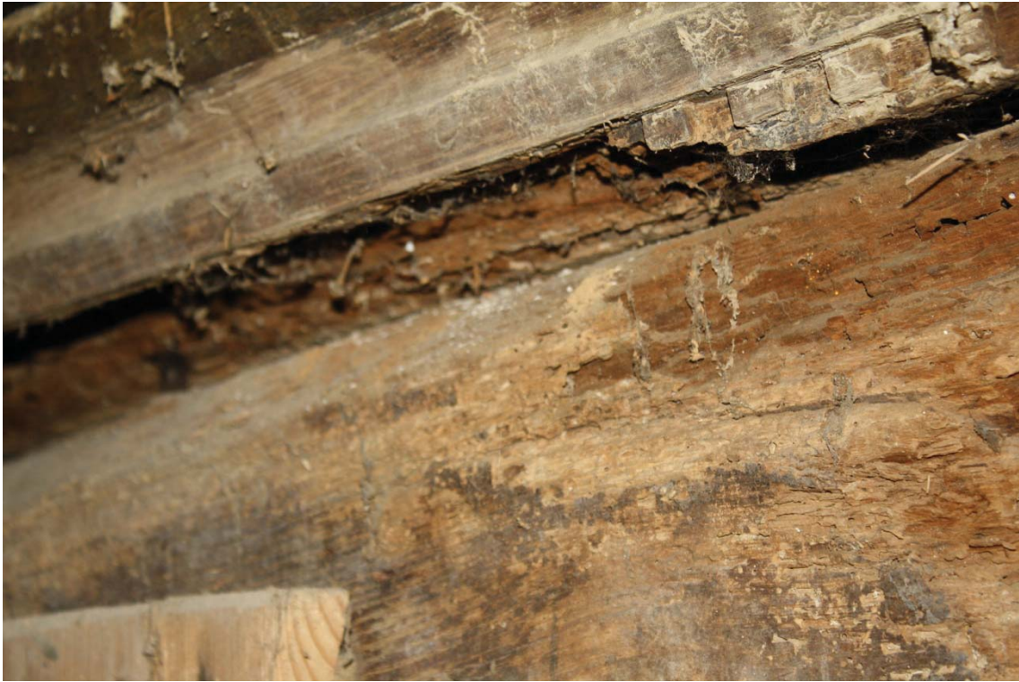
Obr.č.32. poškodenie trámu hnilobou - múčna hrada zdobená zuborezom.
