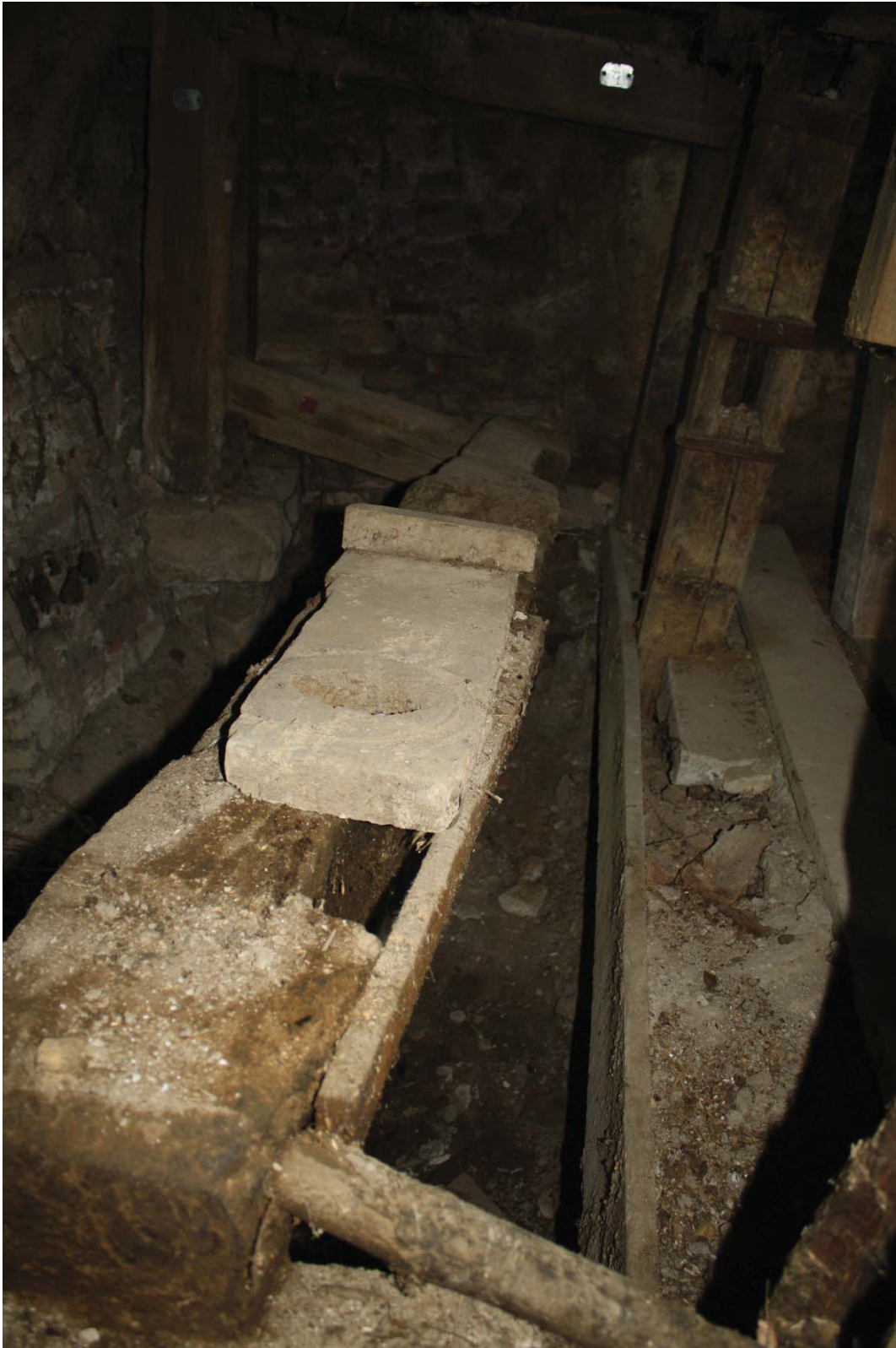
Obr.č.21. drevená konštrukcia mlynskej hranice - stav pred reštaurovaním.
