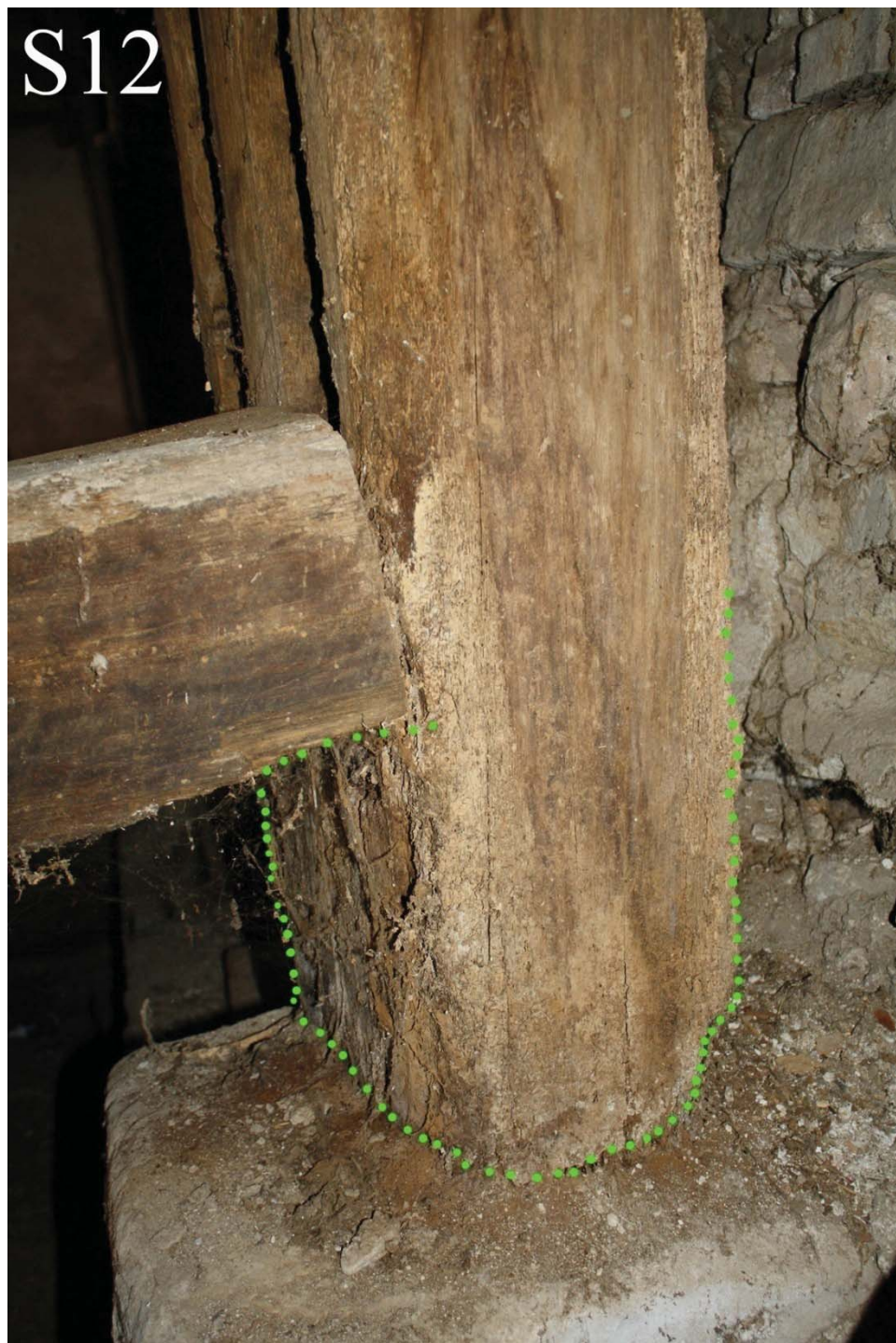
Sonda č.12. lokalizácia poškodených častí hnilobou a drevokazným hmyzom /svorový stĺp- spodná časť dosadajúca na kamennú pätku /
