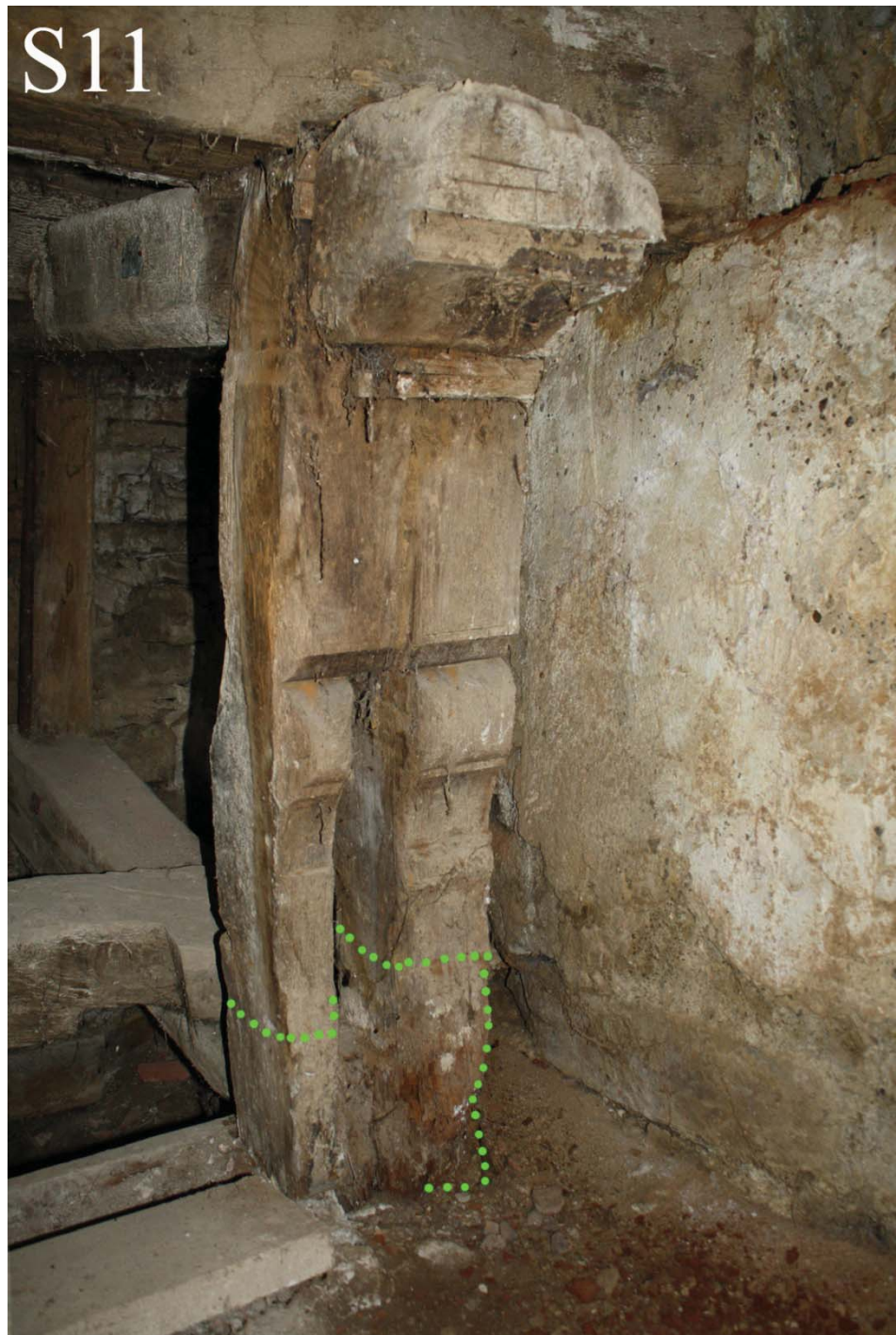
Sonda č.11. lokalizácia poškodených častí hnilobou a drevokazným hmyzom /svorový stĺp- spodná časť dosadajúca na podlahu /
