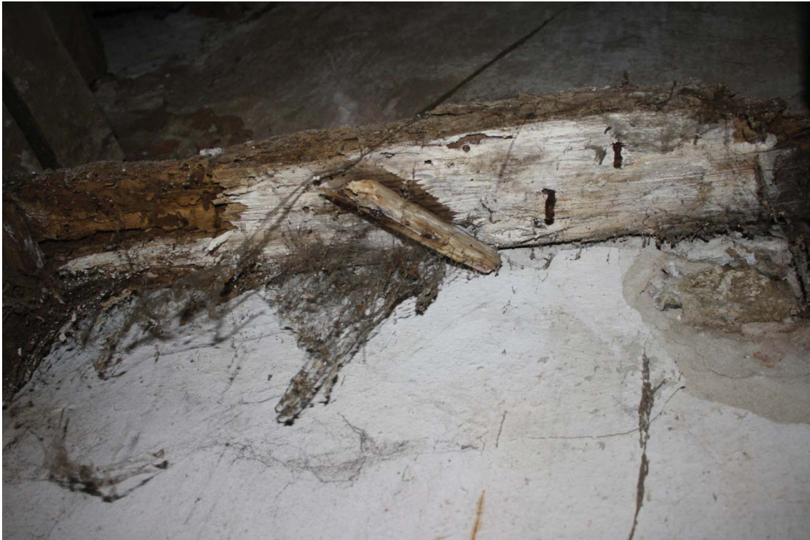
Obr.č.24. poškodenie podesty /medzi podlažia / spodný pohľad.
