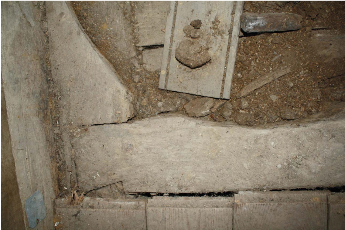
Obr.č.30. poškodenie podesty /medzi podlažia / detail.
