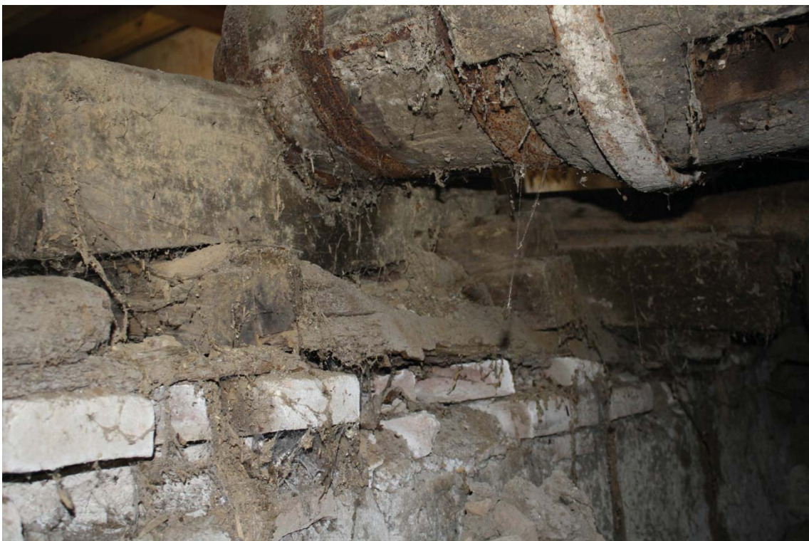
Obr.č.25. stav poškodenia základu a drevených častí pod hriadeľov.
