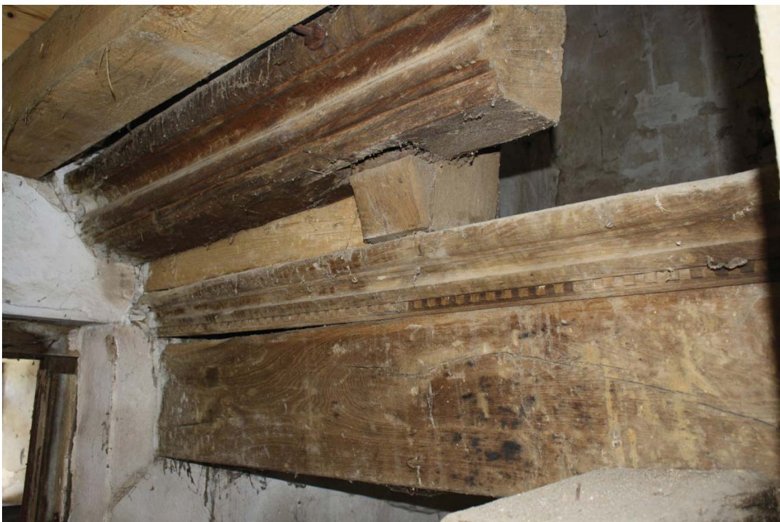
Obr.č.33. poškodenie profilovaného trámu zábradlia prerezaním.
