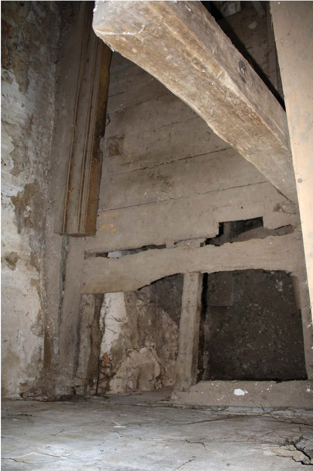
Obr.č.19. poškodenie podesty /medzi podlažia / vrchný pohľad.
